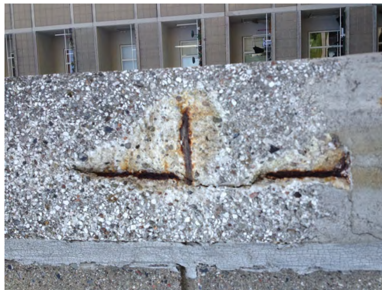
Illustration 8. Eksempel på afskalning over rusten armering i lodret facadebånd. Dæklag 10-15 mm. 24 A, østsiden.
