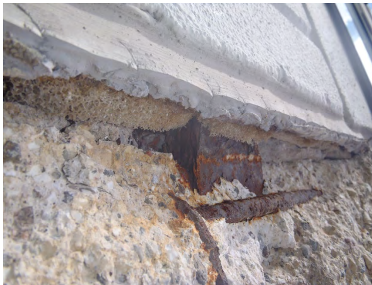
Illustration 14. Nærbillede af korroderet låse ved karnap, taget nedefra.
