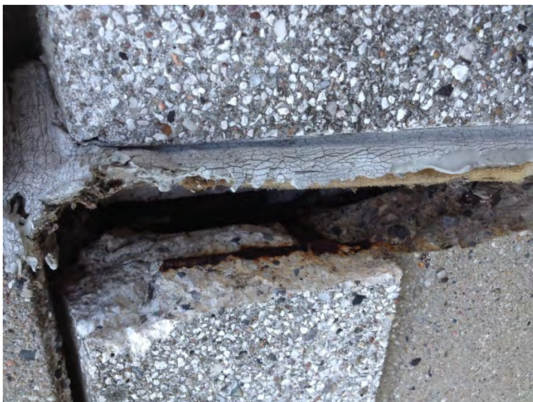
Illustration 7. Eksempel på korrosion i øverste hjørne af element. Afskalning taget ned da den var løs. Der ses ca. Ø6 mm karmstål i for- og bagsiden, forbundet med et bånd. 24 A, østsiden.
