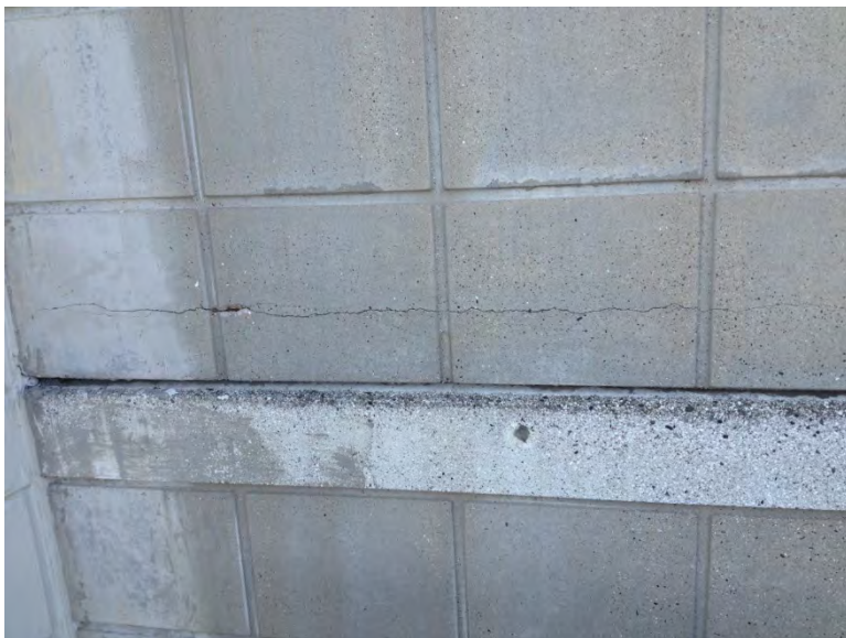
Illustration 5. Eksempel på vandret revne over armering i bund af element. 24 A, østsiden.
