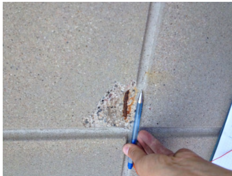
Illustration 6. Eksempel på afskalning over vandret yderligt liggende armering i bund af element.
