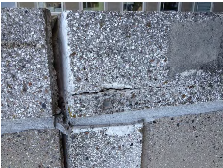
Illustration 9. Eksempel på revner i lodret facadebånd. Afskalning sad fast og er ikke fjernet.
