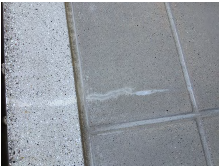
Illustration 1. Eksempel på revne gennem vandret facadebånd og ned i udsparring. 24 A, nordsiden.
