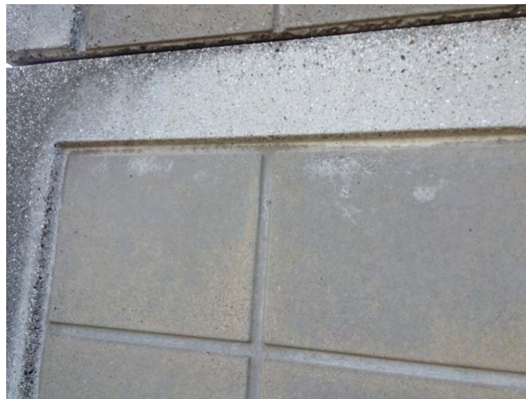
Illustration 2. Eksempel på revne gennem vandret facadebånd.
