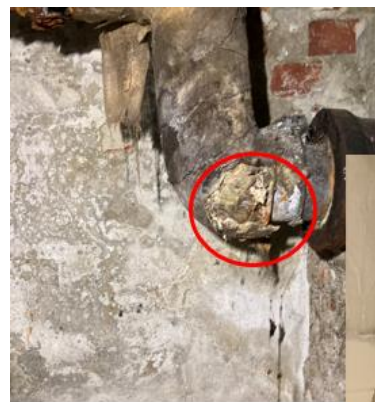
Isolering på rør
